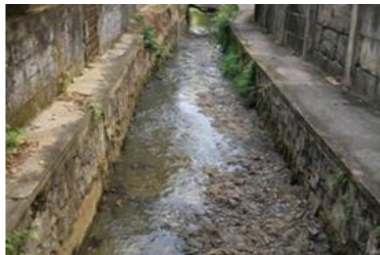
Gambar 2. Saluran Drainase dengan Sedimen Tanah.
