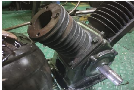
Gambar 9 Korosi di Bagian Rangka Kompresor
