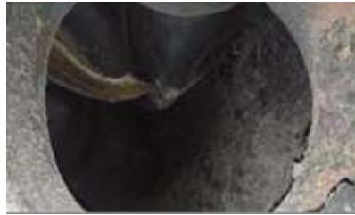
Gambar 3 Kondisi dinding furnace
