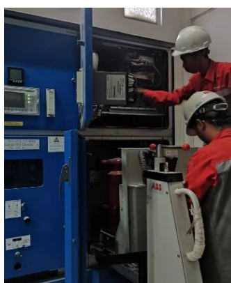
Gambar 11. Proses Pengeluaran Vacuum Circuit Breaker ( Sumber Dokumentasi Pribadi)
