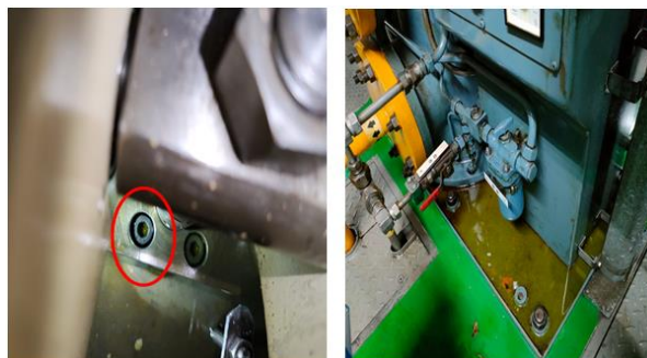
Gambar 3. Plat crack/retak dan kondisi drip tray oil penuh.
